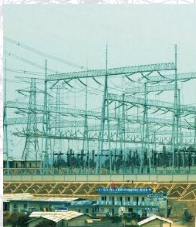
南方电网 江门宏大机电项目
