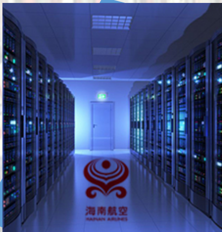
海南航空数据中心机房
