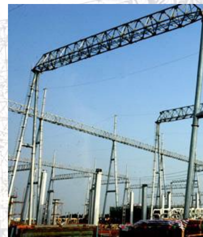
南网广东顺德科达洁能 光伏发电项目
