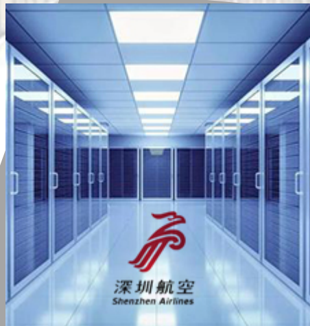
深圳航空数据中心机房
